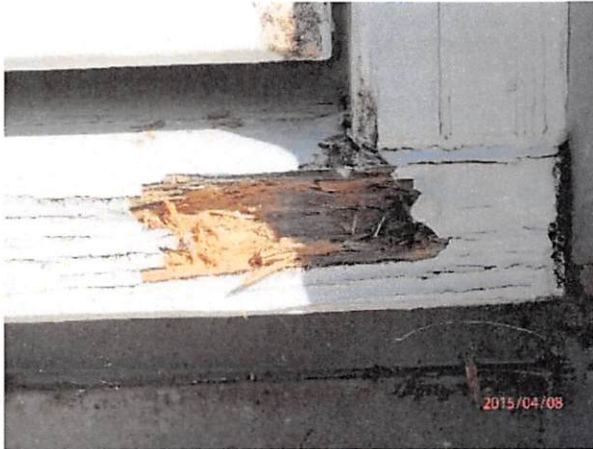
Trænedbrydende skader i karmtræ.
