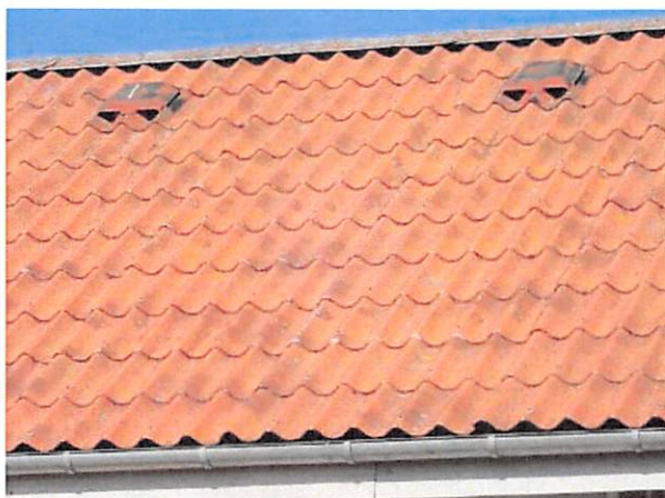
Der ses tiltagende afskalninger på særligt tagplade kanter. Rygningsplader er med væsentlige afskalnings skader.
