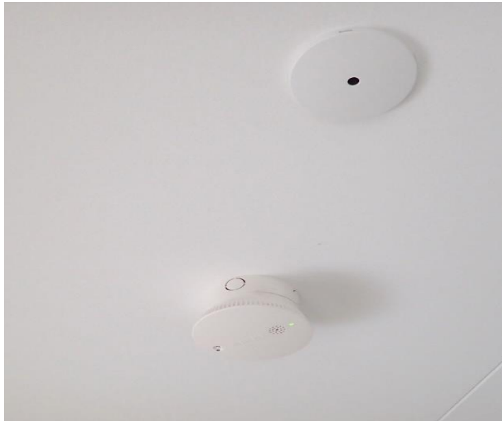
Røgalarm monteret i entre
