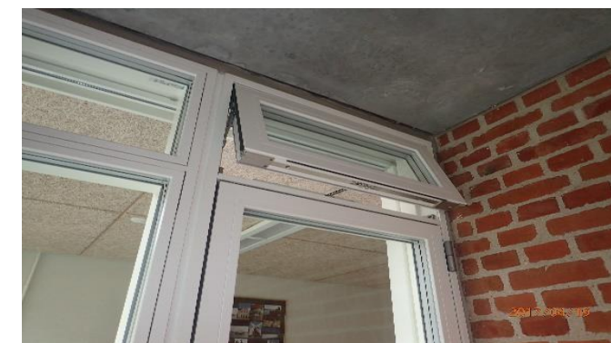
Oplukkelig ramme over altandør
