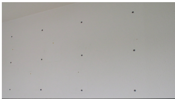
Borehuller i væggen.
